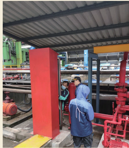
消防泵浦檢測
