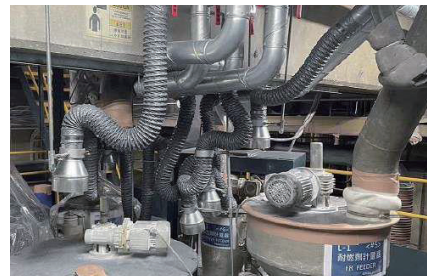
粉塵作業增設局部排氣設施
